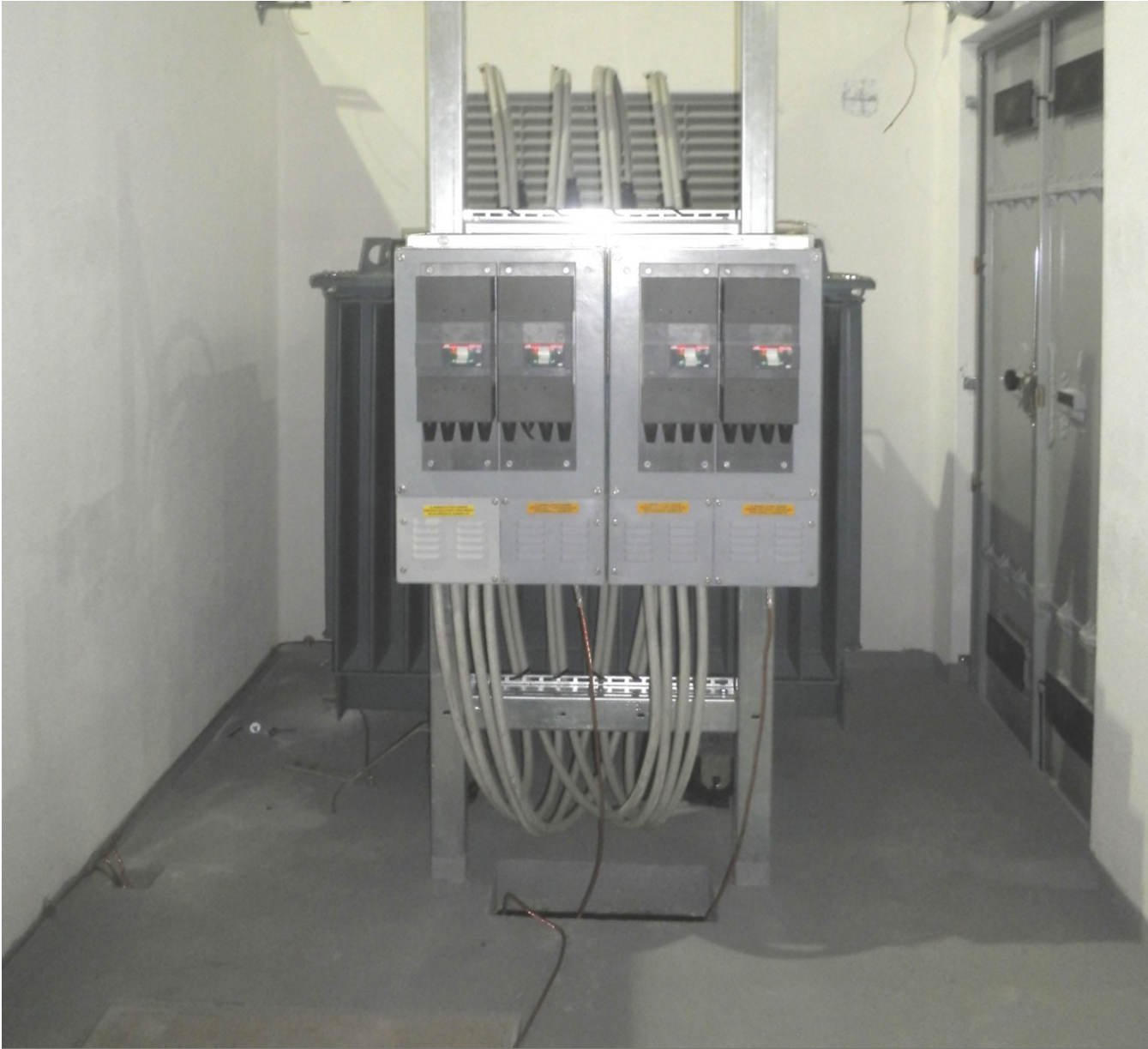
Esempio quadro BT installato
